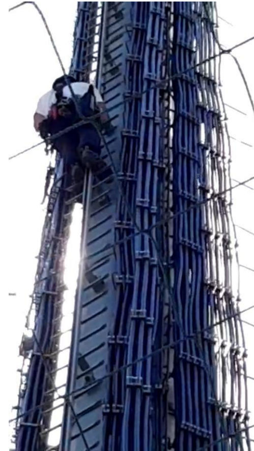
Antenne per telecomunicazioni monitorate a Roma, Assago e Napoli
