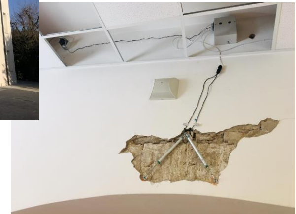
Sistema di monitoraggio installato presso "Scuola Novello" di Ferrara
